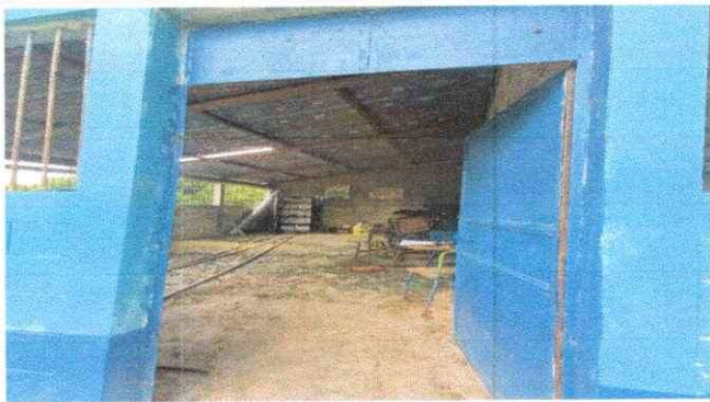
Foto 3: Se observa el deterioro de las puertas de la escuela.
