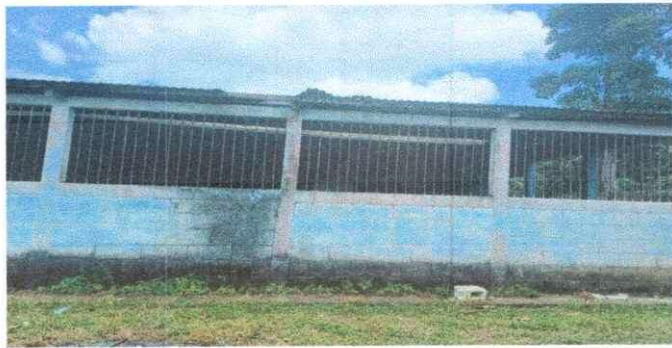
Foto1: Se observa el deterioro de la pintura de la pintura de la pared y valcones.
