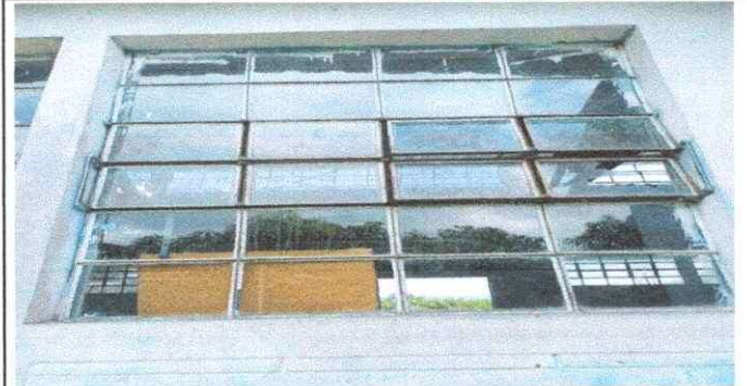
Foto 2: Se observa el deterioro de la estructura metalica y vidrio de las ventanas
