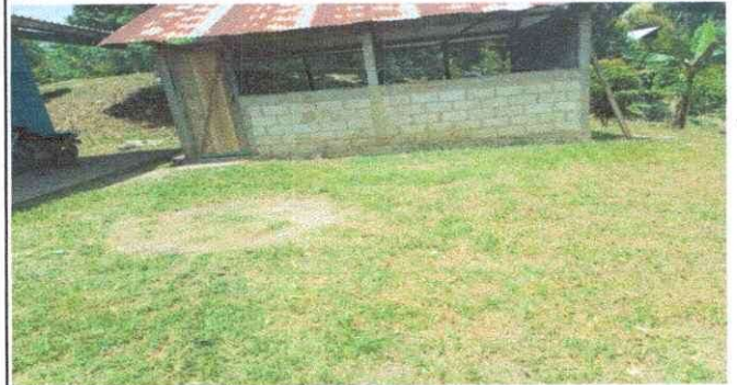
Foto 4: Se observa el deterioro del entechahdo y la pared de la cocina.
